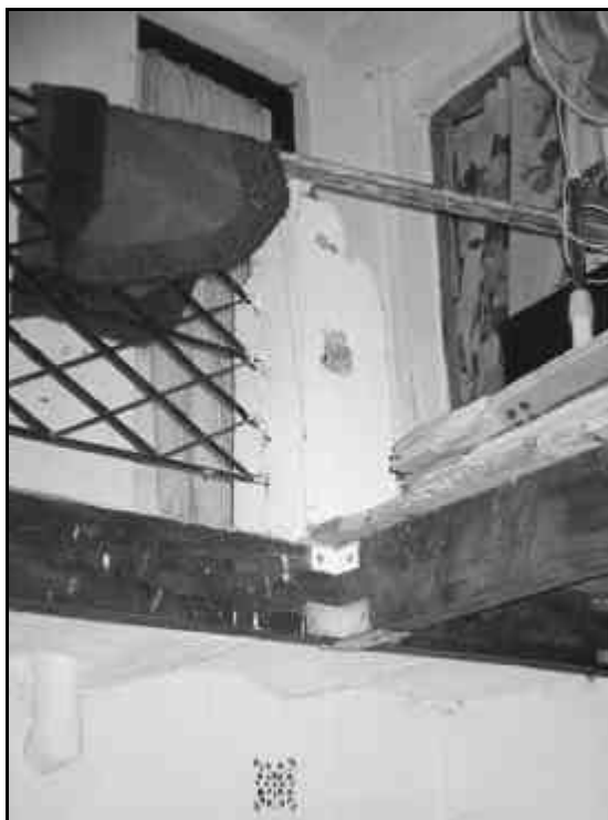
Las construcciones clandestinas ponen en peligro a los inquilinos
